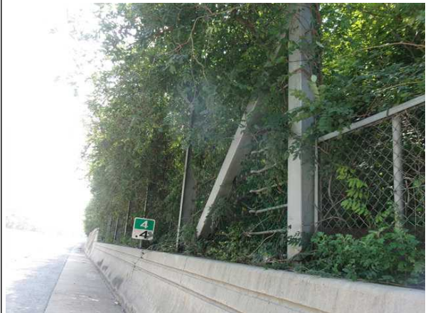
도로부, 낙석방지울타리 전경
