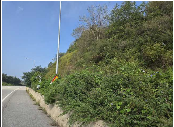
도로부, 낙석방지울타리 전경
